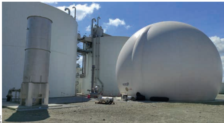
▷ Situé à Ginestous (Toulouse), ce stockeur exécuté pour Veolia et opéré par Suez dispose d'une torchère de 1 000 Nm 3 /h conçu par Hofstetter et d'un gazomètre de 2 000 m 3 fabriquée par Sattler.
